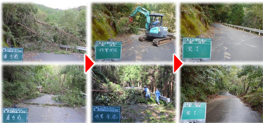
災害状況（着工前）
