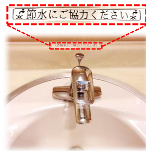
目に付く場所にシールを貼り注意喚起しています。
