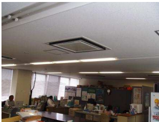
照明の間引・配置見直し
