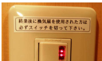
トイレ換気扇
